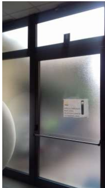
Porta di emergenza n. 2 Aula Didattica
